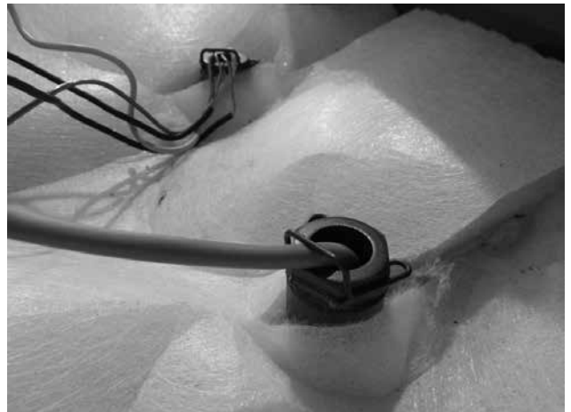
Abb. 16 - Ansicht des Wassertemperaturfühlers TK im Schutzrohr des Kessels DxxP
