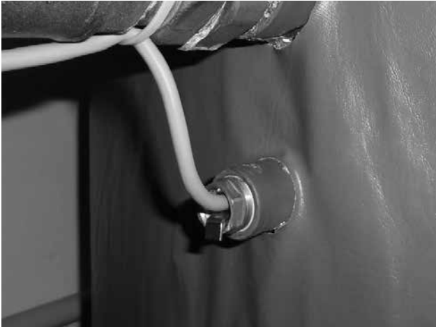
Abb. 13 - Ansicht auf Wassertemperaturfühler im Schutzrohr des Pufferspeicher (TV und TS)
